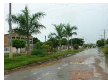
Rua Deteriorada em Função da Falta de Sistema de Drenagem
